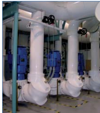
Proyecto de enfriamiento del distrito, Phoenix, EE. UU.
